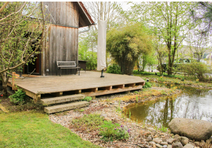
Bei Terrassen ist Holzpflege nicht nur eine Frage der Optik. Die Dielen sind einer starken Belastung ausgesetzt. Im Hohlraum darunter staut sich in unseren Breiten die Feuchtigkeit. (Bild: Natural-Farben)
